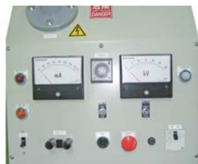
【パネル操作部】
